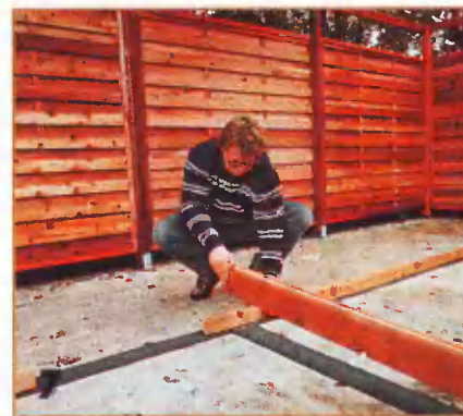
Под доски нижнего венца на плиту фундамента настелили полосы рубероида в качестве гидроизоляции.
