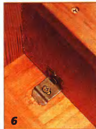
6 Вид стола снизу. По бокам столешницу крепят на мебельных стяжках, которые имеют овальные отверстия под шурупы. Это обеспечивает некоторую свободу перемещения деталей при усадке или расширении древесины.
